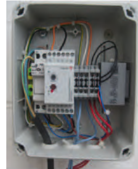
câblage boitier bac tampon
